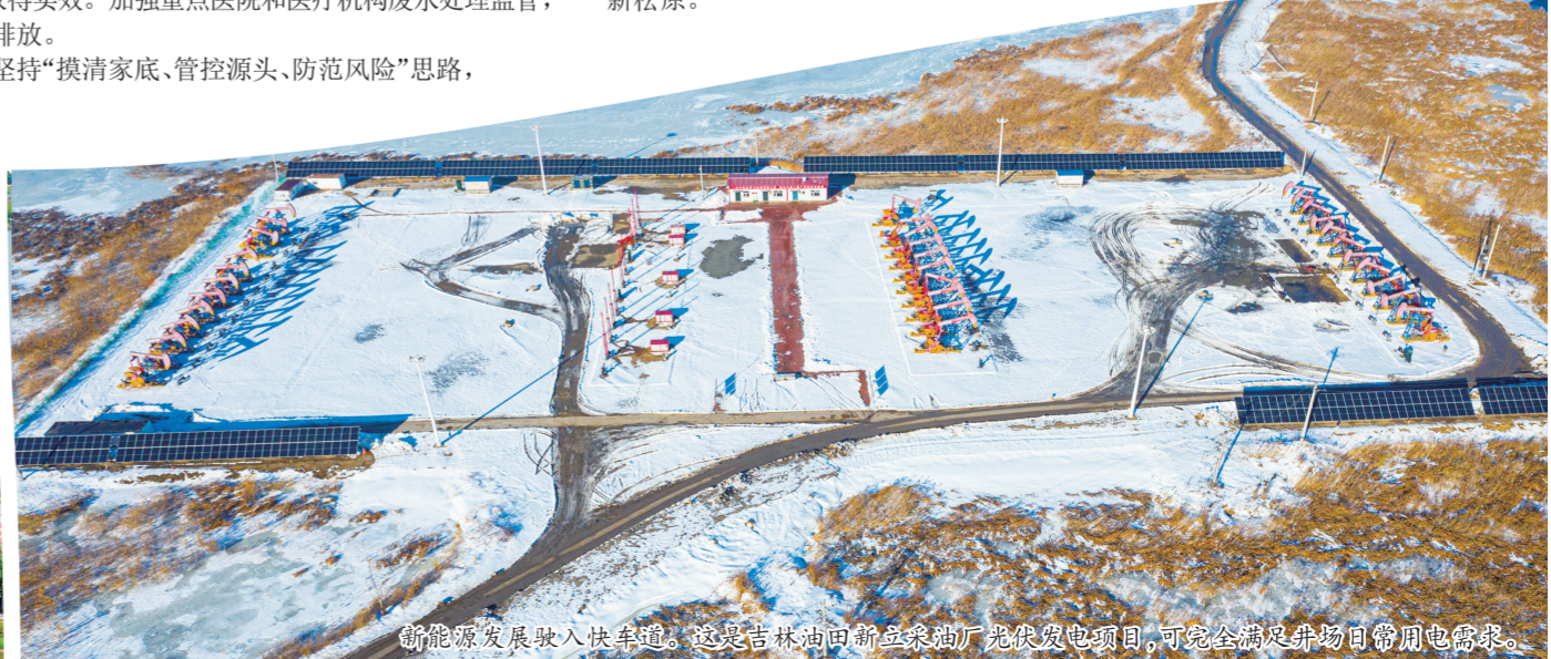
新能源发展驶入快车道。这是吉林油田新鱼梁油厂光伏发电项目,可完全满足场站日常用电需求。
