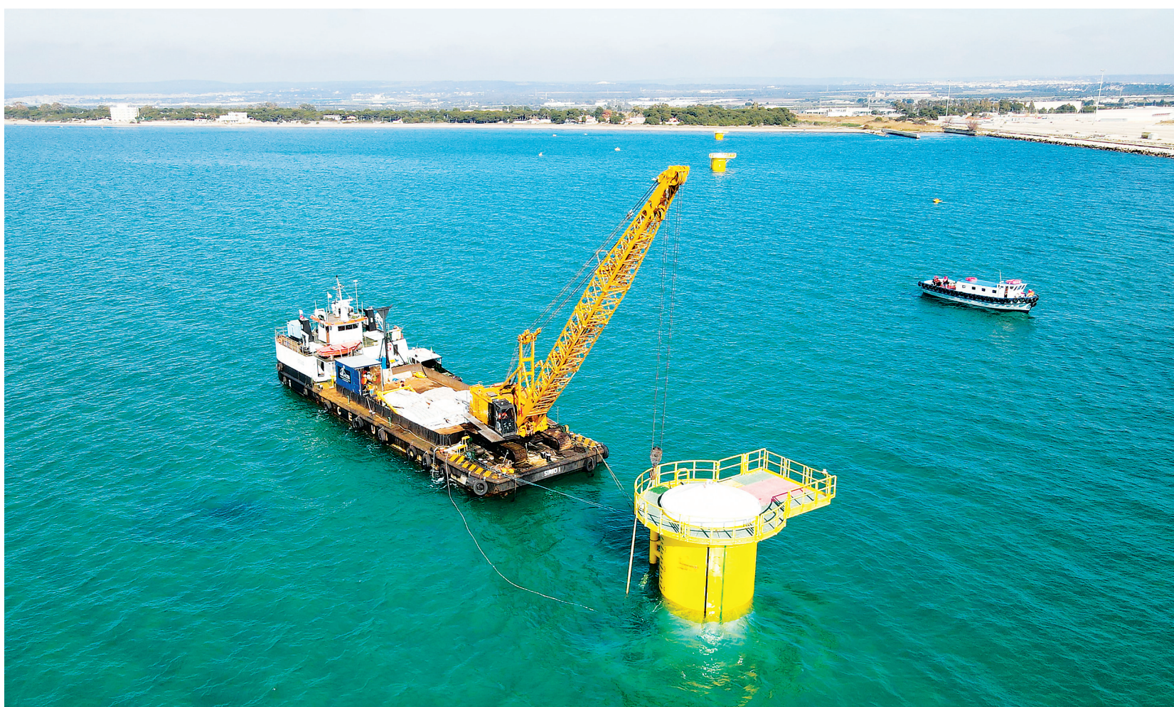
在意大利南部海港塔兰托，作业船检查海上风机单桩基础(1月27日摄)。目前，中国明阳智慧能源集团股份公司(明阳智能)的海上风电设备正在意大利南部重要海港塔兰托港口安装。中国技术、国际合作让意大利向着增加清洁能源、应对气候变化的目标又迈进了一步。
