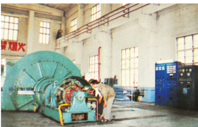
1980年“长春一次变”第一台氨冷调相机投产运行
