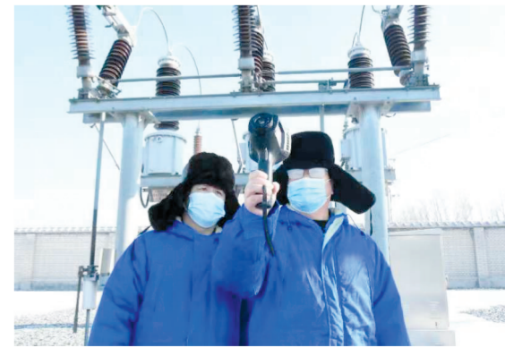
近日,国网长春市九台区供电公司组织人员对所辖变电站设备开展红外测温工作。根据负荷变化和实际健康情况,他们对变压器、开关、刀闸等设备进行了红外测温,及时掌握设备接点温度情况和设备隐患,对影响设备安全运行的问题,立即进行消除和处理,确保变电站设备和电网的安全运行。付瑶 摄
