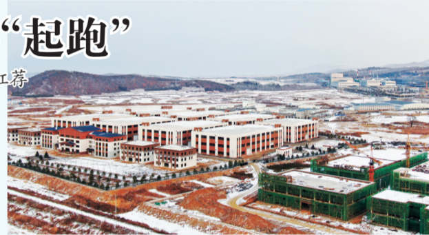
柳河工业集中区大健康产业园区基础设施(标准厂房)建设项目施工现场。赵宁 摄
