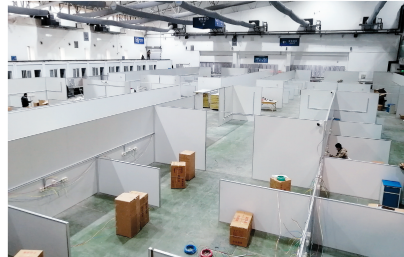
正在建设中的长春国际会展中心方舱医院(3月12日摄)。记者从长春国际会展中心方舱医院建设现场指挥部获悉,拥有1500多张床位的方舱医院正在加紧建设中。同时,方舱医院附近的展馆还建设了临时隔离点,床位700多张。新华社记者 张建 摄
