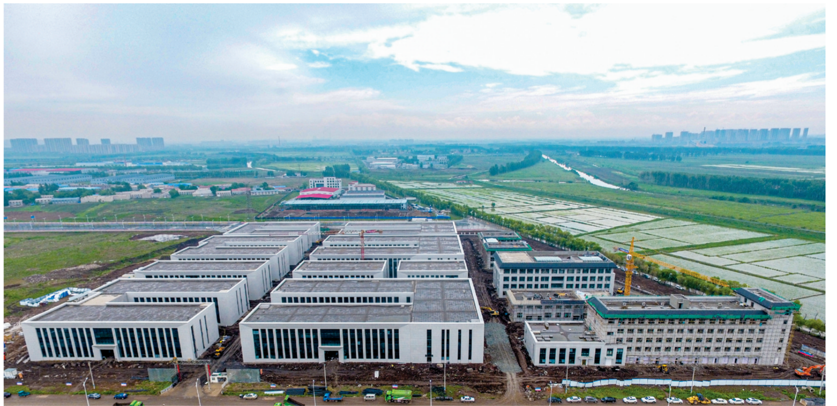
由中铁建大桥局六公司承建的长春汽开区新能源汽车产业园项目，是长春国际汽车城的首批落位项目，是承接省市“六个回归”战略任务的重要举措。目前，该项目A区正加快施工进度，确保项目早竣工、早投产、早达效。
