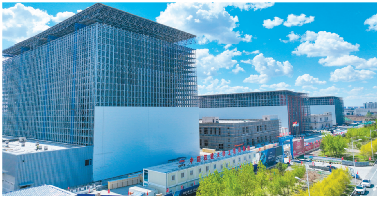
中韩(长春)国际合作示范区冷链物流产业园建设项目,是我省打造对外合作桥头堡的重要举措,项目建成后,将形成以中韩示范区为基点,面向周边国家、服务全国的大型跨境电子商务中心。目前,项目正紧锣密鼓向前推进。图为项目航拍图。 李天玉 本报记者 丁研 摄
