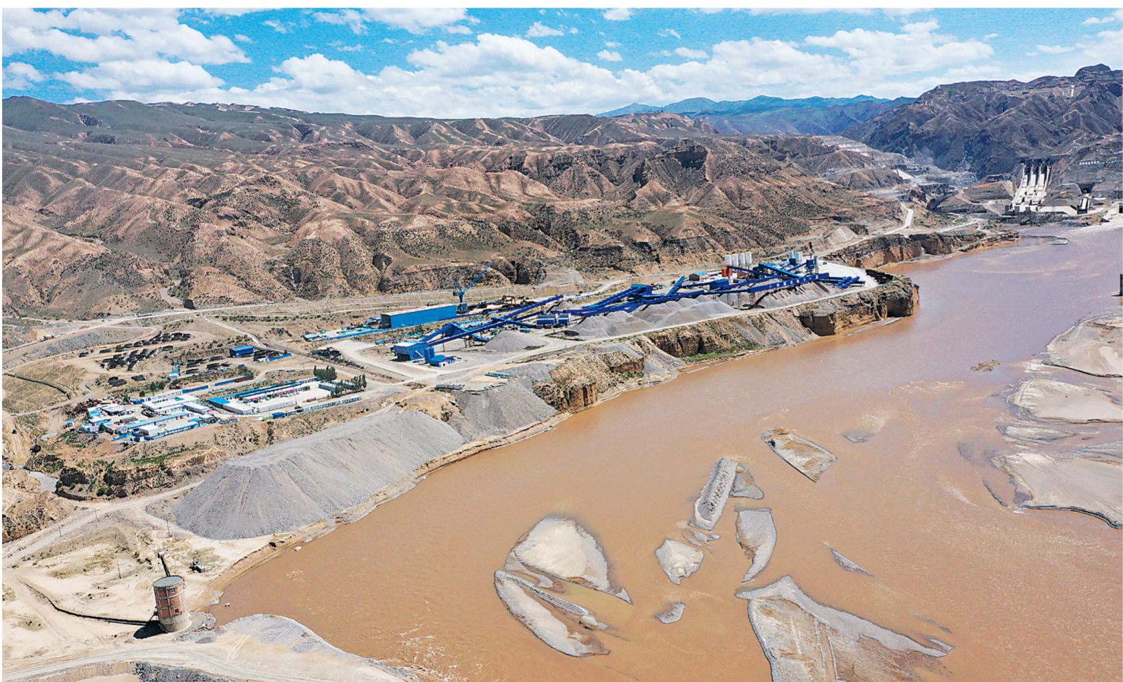
这是6月22日拍摄的建设中的羊曲水电站一角(无人机照片)。电站总装机容量120万千瓦,水库总库容16.39亿立方米。建成投产后每年可节约标准煤耗146.7万吨,可减少二氧化碳排放量441.2万吨。 新华社记者 骆晓飞 摄
