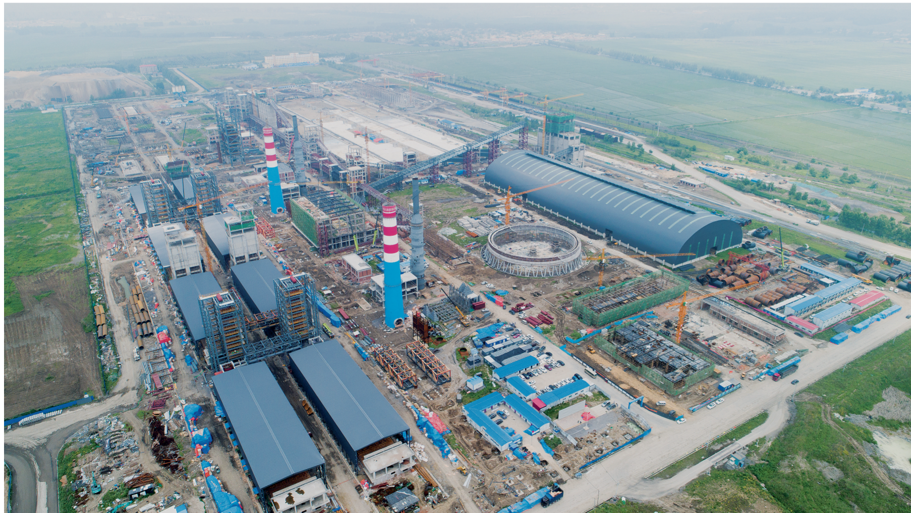
截至目前,吉林市龙潭区上半年已开复工5000万元以上重点项目21个,计划总投资84.6亿元。投资21亿元的建龙钢铁120万吨冷轧等重点项目已经全部开工。上半年预计完成投资11.2亿元,同比增长15%。图为吉林建龙150万吨焦化项目建设现场。
