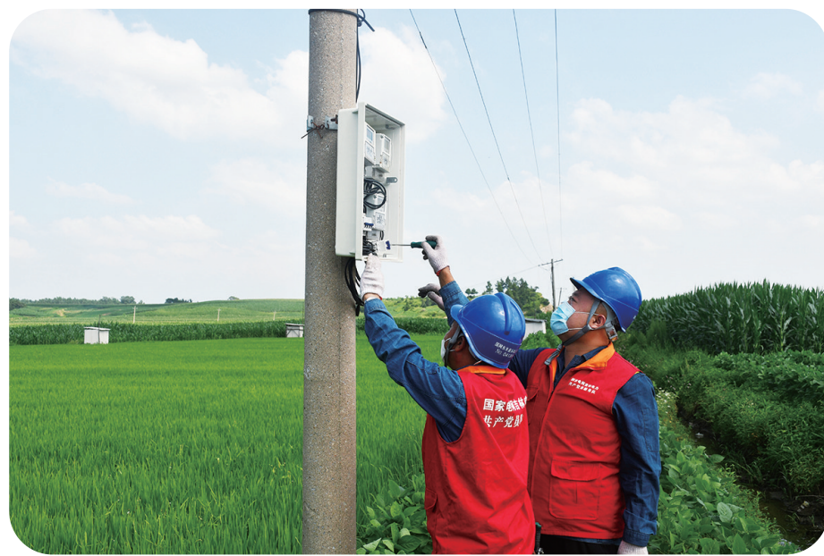
日前,国网辽源供电公司共产党员服务队队员扎实开展提质增效主题实践活动,深入杨木镇永新村4组水稻抽穗排灌地头,对小水泵开展用电隐患排查,保障农业安全稳定用电,为乡村振兴充电站赋能。 陆东伊 摄
