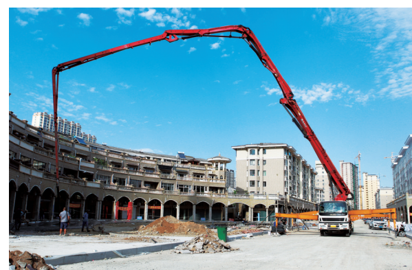
福源路步行街改造工程,预计九月末建成通车,正在进行人行步道混凝土浇筑工程。 董博 摄
