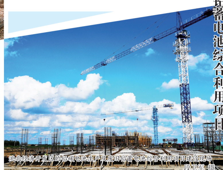
洮北区铅酸电池生产及废旧铅蓄电池综合利用项目 段卫军 摄
