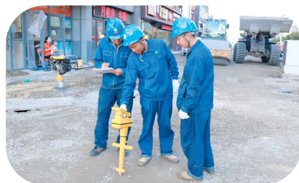
日前,国网松原供电公司配电运检班职工为海城市建设现场排查电缆安全运行情况。 吉翔泽 摄
