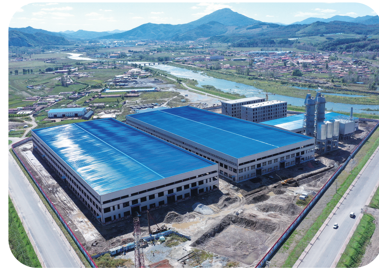
二道江区续建项目火力全开,鑫鸿年产300万吨环保新材料产业基地项目主体完工。
