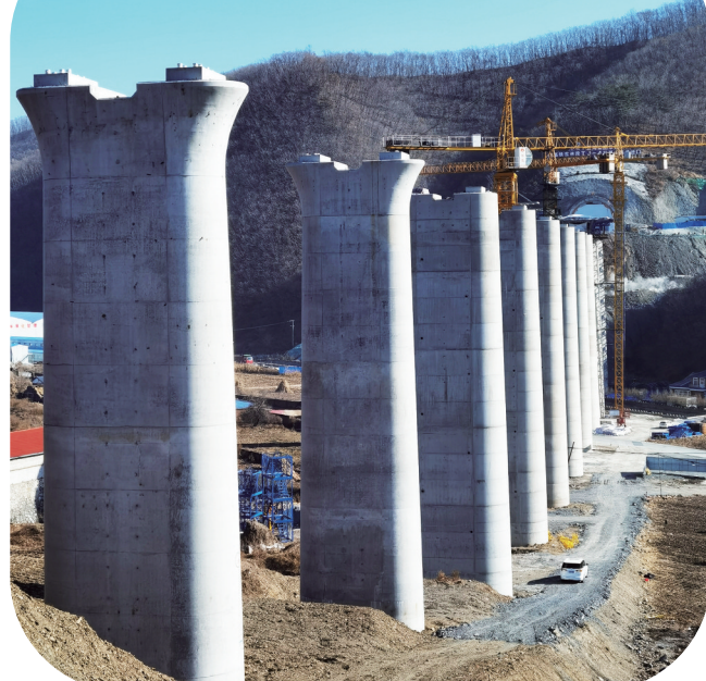
沈白高铁吉林段TJ-4标,全长478.72米的大祥沟大桥10个桥墩横亘于山岭之间,十分壮观。 本报记者 隋二龙 摄
