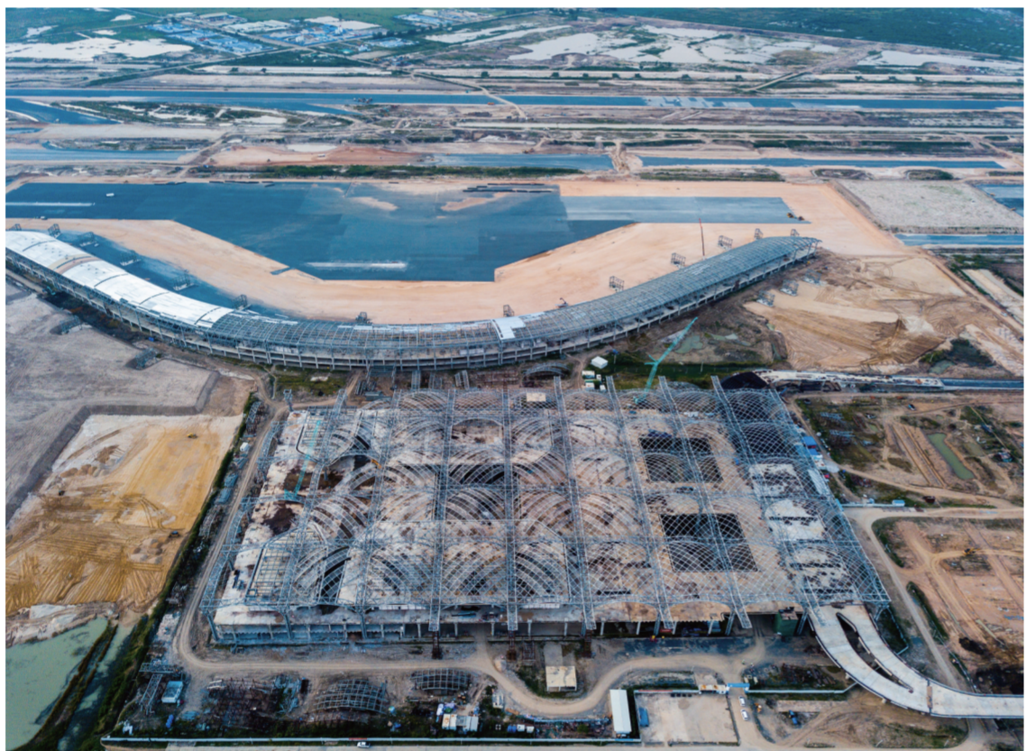
这是11月8日拍摄的柬埔寨新金边国际机场项目施工现场(无人机拍摄)。
