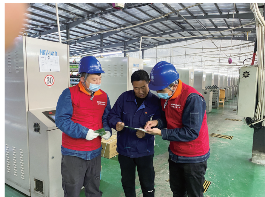
11月15日,东辽县供电公司深入新金祥纺织公司生产车间,对用电设施以及配电箱进行安全隐患排查,努力当好企业“电保姆”。 全天野摄
