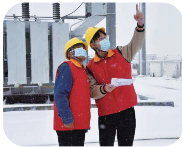
自今冬首场雪以来,国网农安县供电公司及时组织人员对辖区内变电站设备和线路开展特巡,采取积极措施防范积雪融化产生覆冰,消除潜在隐患,确保电网稳定运行。图为服务队巡视设备。张鹏 摄
