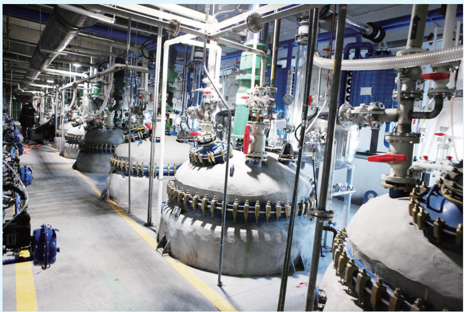
吉林省四合药业科技有限公司的反应罐车间。
