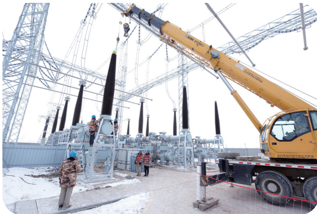
日前,吉林昌盛500千伏变电站扩建工程加紧施工,作业人员在吊装组合电器套管。
