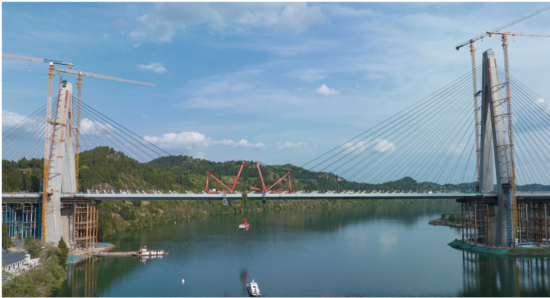
四川路桥的施工设备正在安装汉巴南铁路嘉陵江特大桥的最后一节段钢箱梁(3月30日摄,无人机照片)。由蜀道集团四川路桥承建、中铁五院设计汉巴南铁路嘉陵江特大桥全长1770.82米,最高主塔高164.5米,是一座双线高速铁路高塔塔混合梁斜拉桥。
