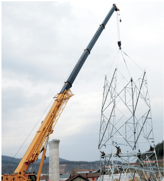
国网白山供电公司加快电力线路迁改,全力推动沈白高铁白山段建设,现已完成50项,预计9月前可完成全部电力线路迁改。赵洪涛 摄
