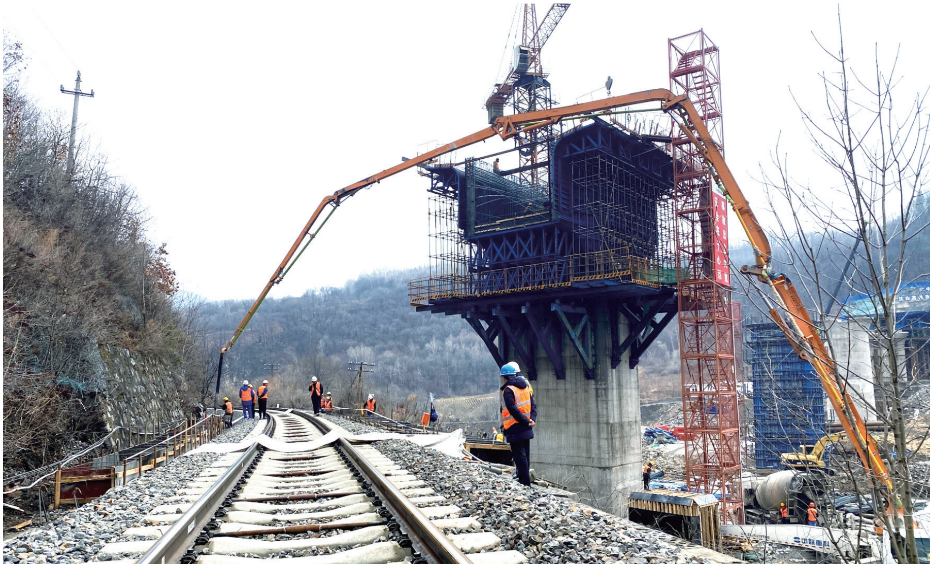
沈白高铁吉林段TJ-6标汤河1号和2号大桥施工现场,来自中铁二十三局集团沈白高铁项目部的建设者正在进行砼浇筑作业。杨景霜 徐龙 摄
