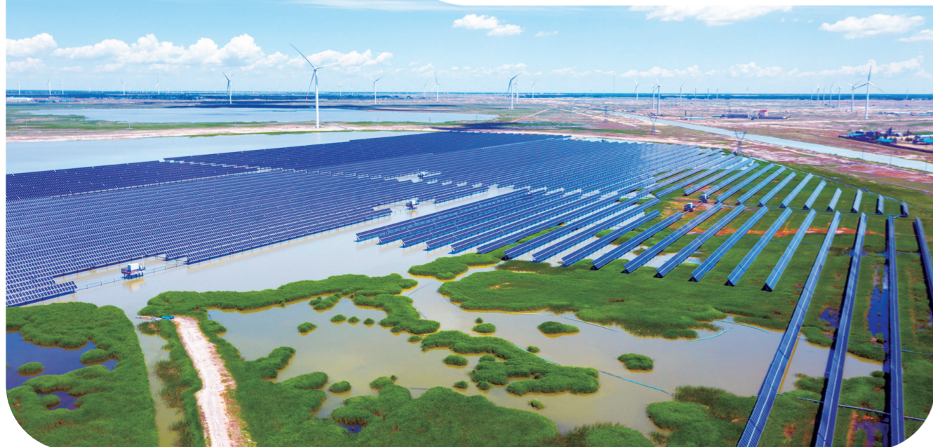
乾安县惠金雨宇光伏电站25MW渔光互补光伏发电项目。
