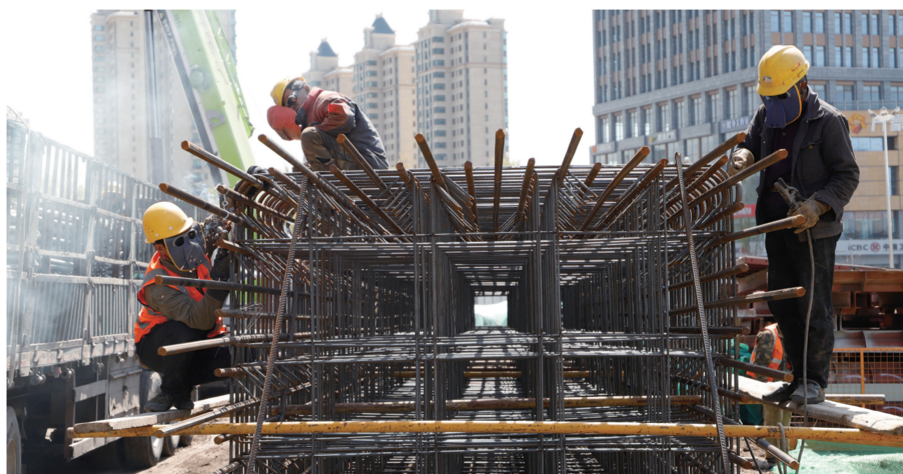
备受关注的长春市世纪广场快速路项目正在全速推进,全体施工工人“五一”期间坚守岗位,加紧施工作业,力争早日竣工。本报记者 潘硕 摄
