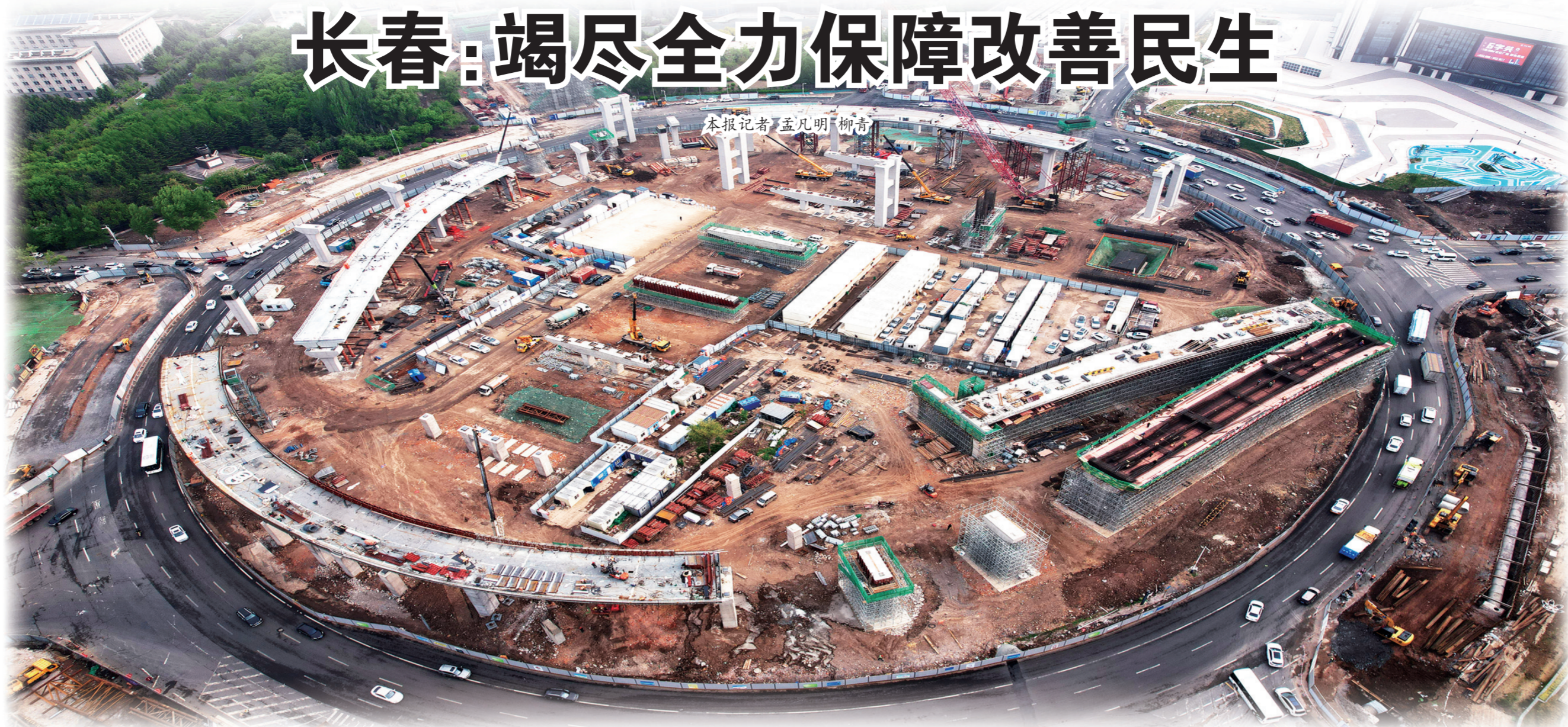
世纪大街快速路项目正在如火如荼建设中,完工后将极大方便居民出行。
