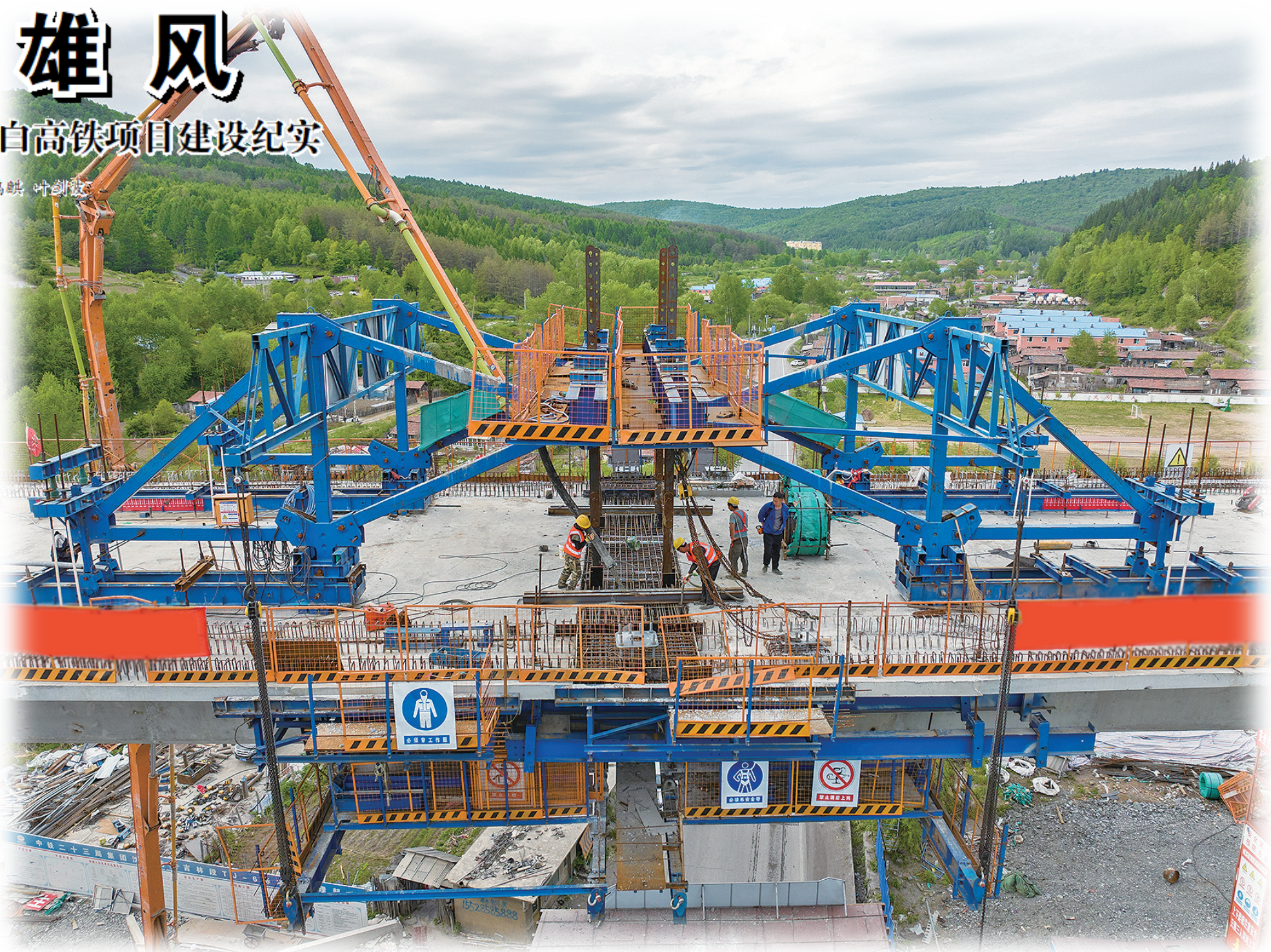
5月31日,中铁二十三局集团承建的沈白高铁吉林段TJ-6标跨201国道大桥连续梁实现空中“牵手”,标志着该标段大桥施工首联连续梁顺利合龙。 杨景霜 陈扬 摄
