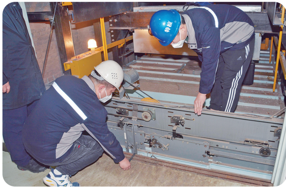
四平市市场监管局特检中心对自动扶梯控制装置进行安全检验。
