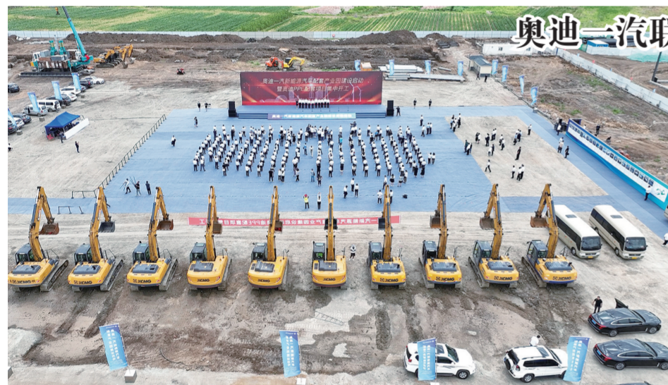
奥迪一汽新能源汽车配套产业园建设启动暨奥迪PPE配套项目集中开工现场。
