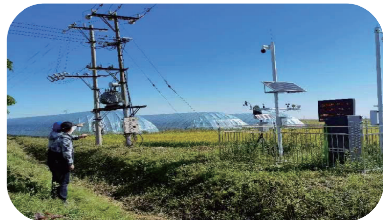
日前,国网永吉县供电公司党员服务队成员来到永吉县河湾子镇前鸭河六社居民家的大棚,检查大棚的用电情况,确保安全用电。刘宇航 摄
