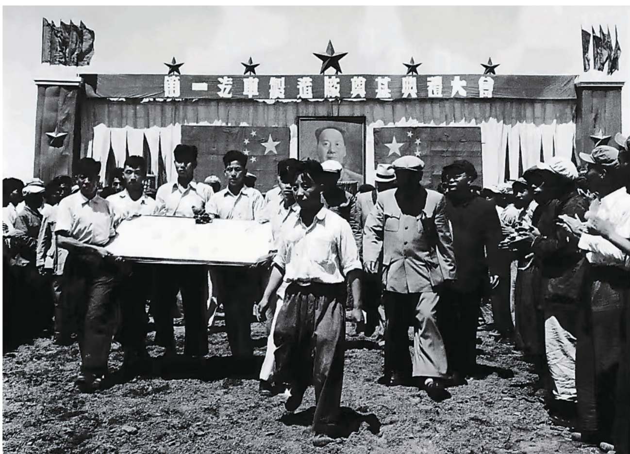
1953年7月15日，第一汽车制造厂隆重举行奠基典礼。奠基仪式上，6名年轻的共产党员在礼乐和欢呼声中，将刻有“第一汽车制造厂奠基纪念”的汉白玉基石安置在场地的中心广场上。(资料图片)
