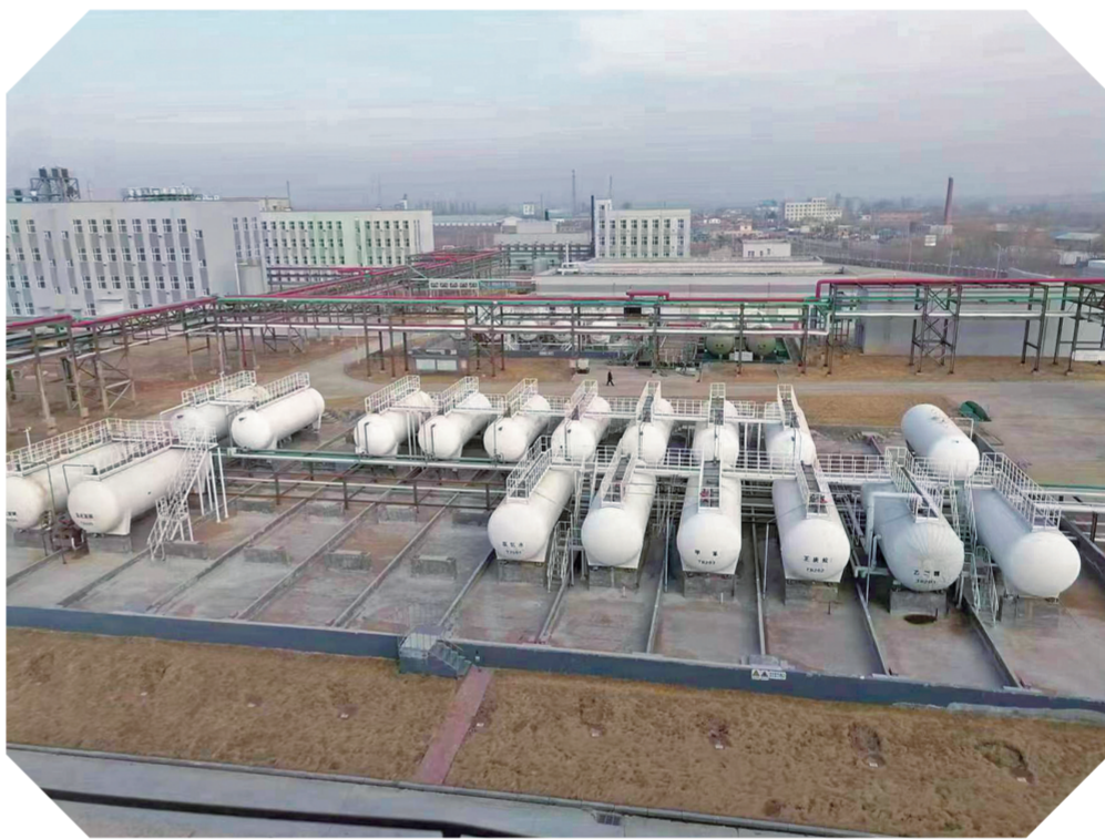
四平市精细化学有限公司建立的DCS控制系统罐区。
