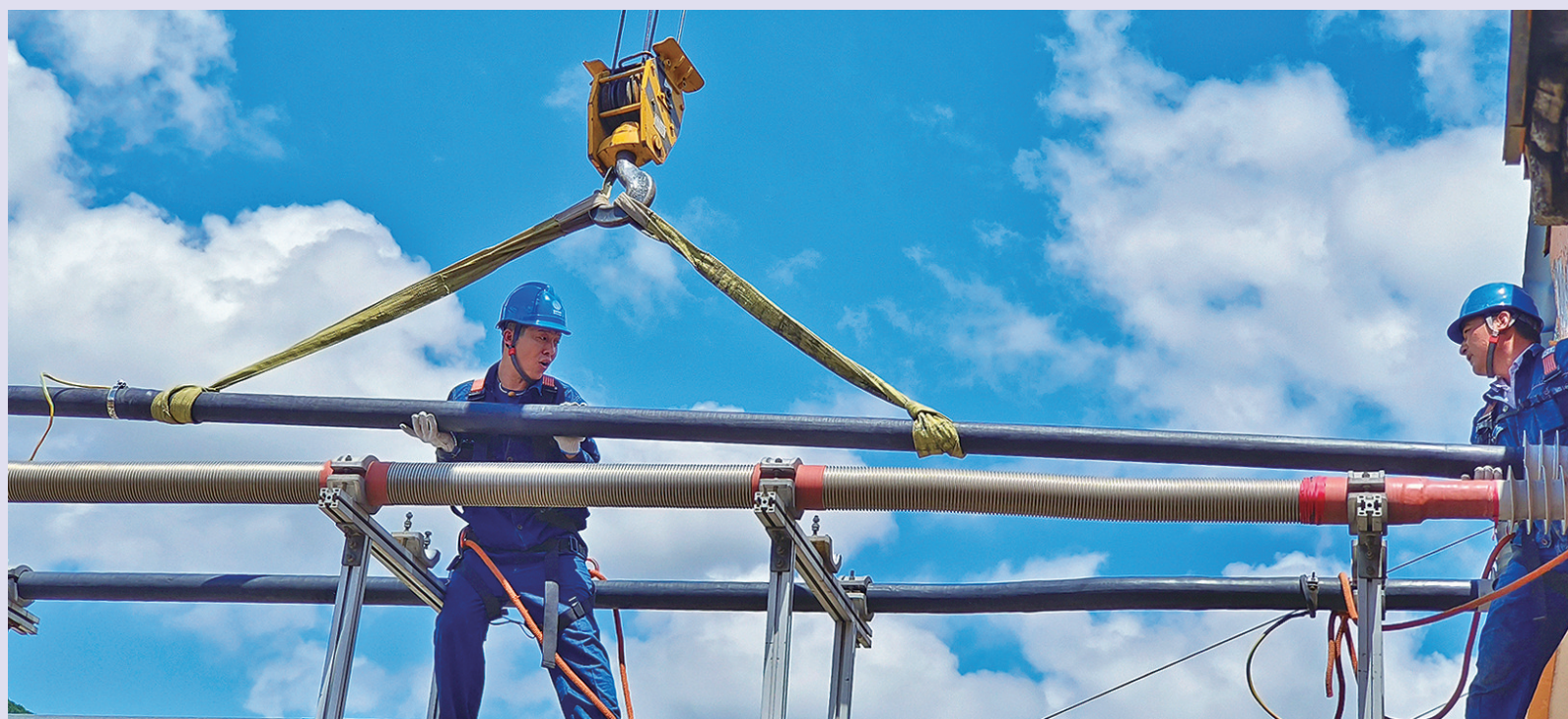
国网白山供电公司持续加大防汛重点部位设备巡视力度,对防汛重点部位开展动态“体检”。同时,强化对水库、排涝泵站等防汛重要用户,医院、铁路等城市“生命线”用户的供电中断风险排查,消除隐患。图为国网白山供电公司变电运检中心对变电站大型设备进行检测维修,确保电网设备安全稳定运行。郭建玲 摄
