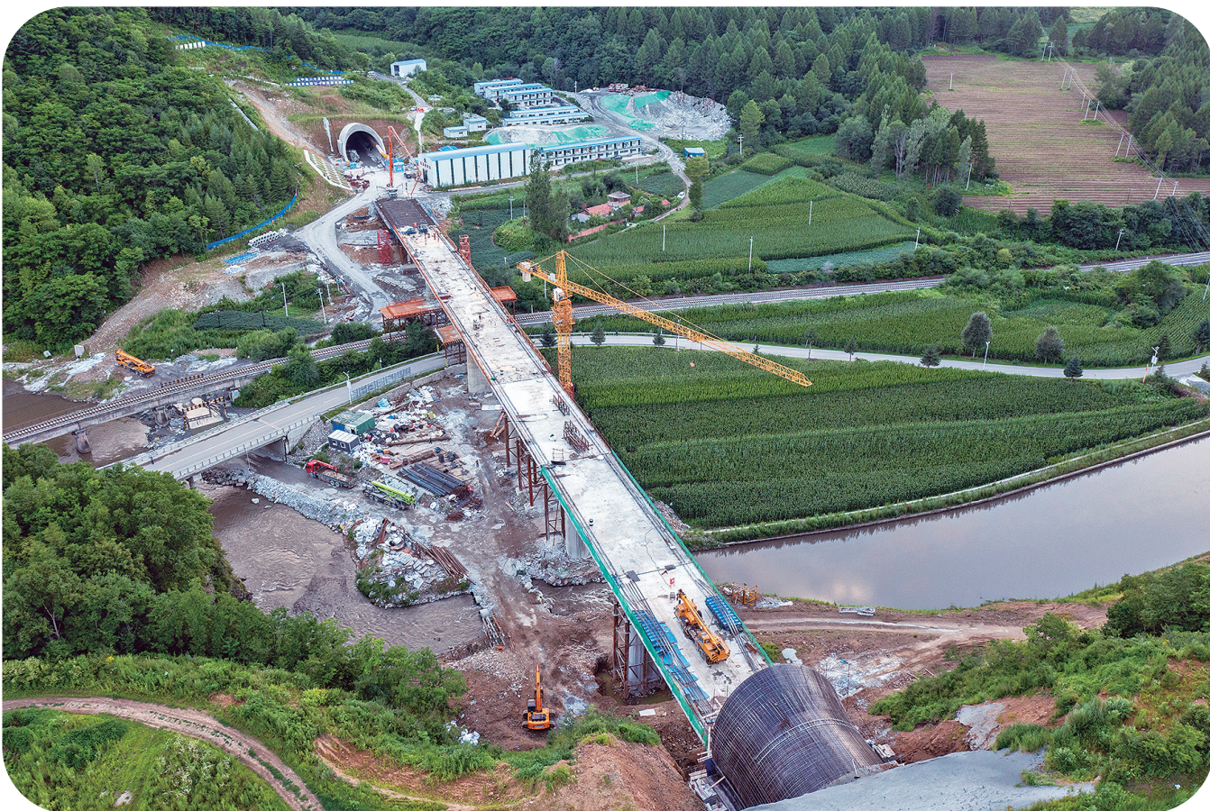
7月29日,由中铁二十三局集团承建的沈白高铁吉林段TJ-6标首座桥梁汤河2号大桥顺利贯通。大桥分别连接黑松谷和黑影岗隧道,是标段控制性工程之一。杨霜霜 陈扬 摄
