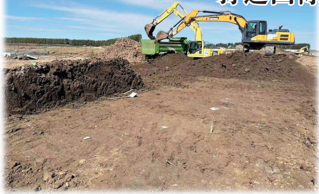
吉林奥来德OLED显示关键材料建设项目正在进行内部施工道路平整。
