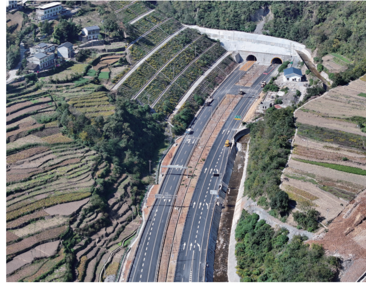
巫镇高速公路三标段施工现场(11月1日摄，无人机照片)。巫镇高速公路是国家高速公路网银百高速G6911巫溪至镇坪段，连接陕西省镇坪县与重庆市巫溪县，全长约48.7公里，总投资98.4亿元，全线桥隧比较高，施工难度较大。目前，巫镇高速公路已全线贯通，预计2024年元旦前正式通车，届时将进一步打通陕西和重庆的水山阻隔，也将为西北地区通江达海提供便捷通道。
