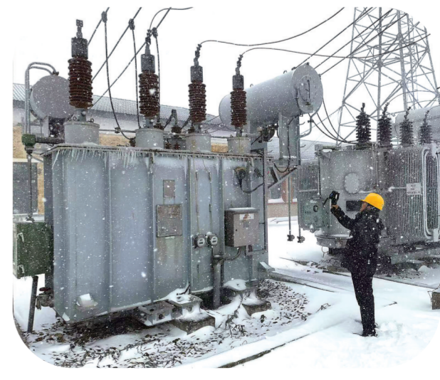
日前,受冷空气影响,扶余市迎来了一场大面积降雪天气。正值供暖季节,为了保证企业和居民正常供电,国网扶余市供电公司组织人员以最高的标准、最有效的组织措施,对全市变电站及输电线路进行特巡,保障低温雨雪天气下生产生活用电需求,确保安全可靠供电。 郑晓玲 摄
