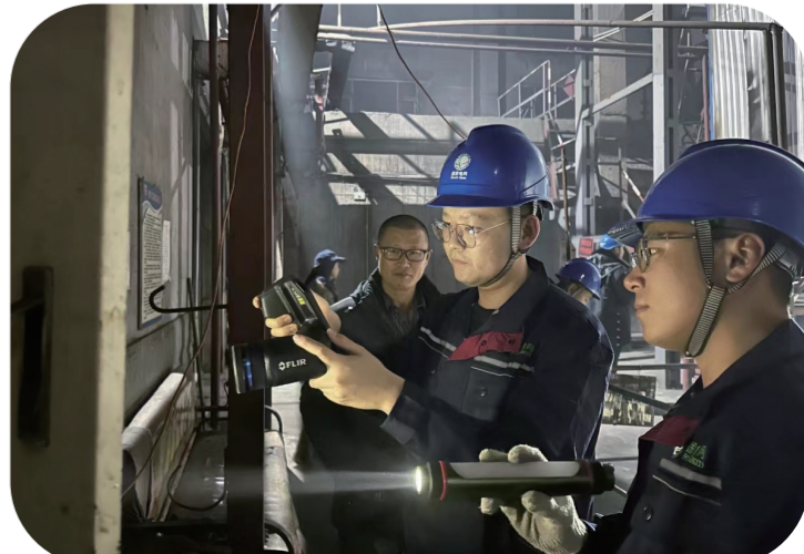
近日,国网白山供电公司长白县公司对长白同鑫热力有限公司供电设备开展巡检检查,确保长白县冬季供暖设备安全可靠供电。图为该公司员工张朋瑞、孟凡博对供热电力设备进行红外测温检查。张宇 摄
