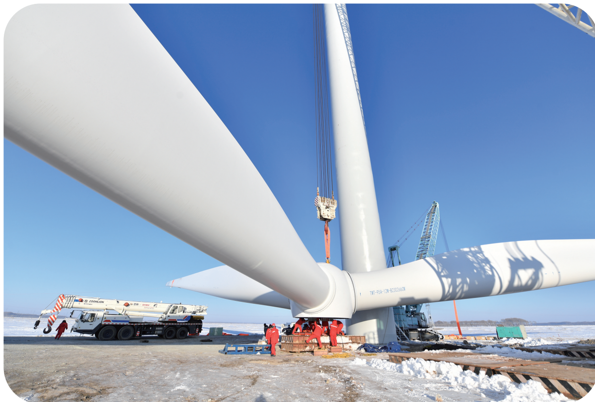
吉林油田昂格55万千瓦风电项目由于所在地地势低洼，夏季根本无路，唯有冬季才是施工黄金期。图为首台风机吊装现场。
