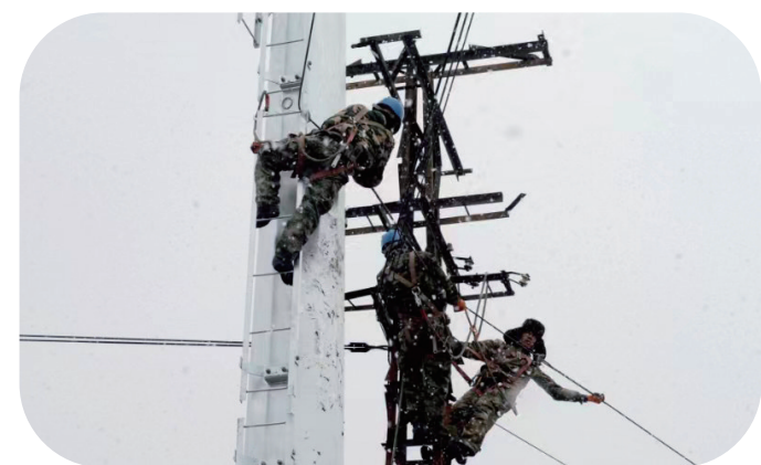
日前，国网白山市江源区供电公司员工在风雪寒潮中开展农村电网改造施工。图为该公司员工在作业施工。
