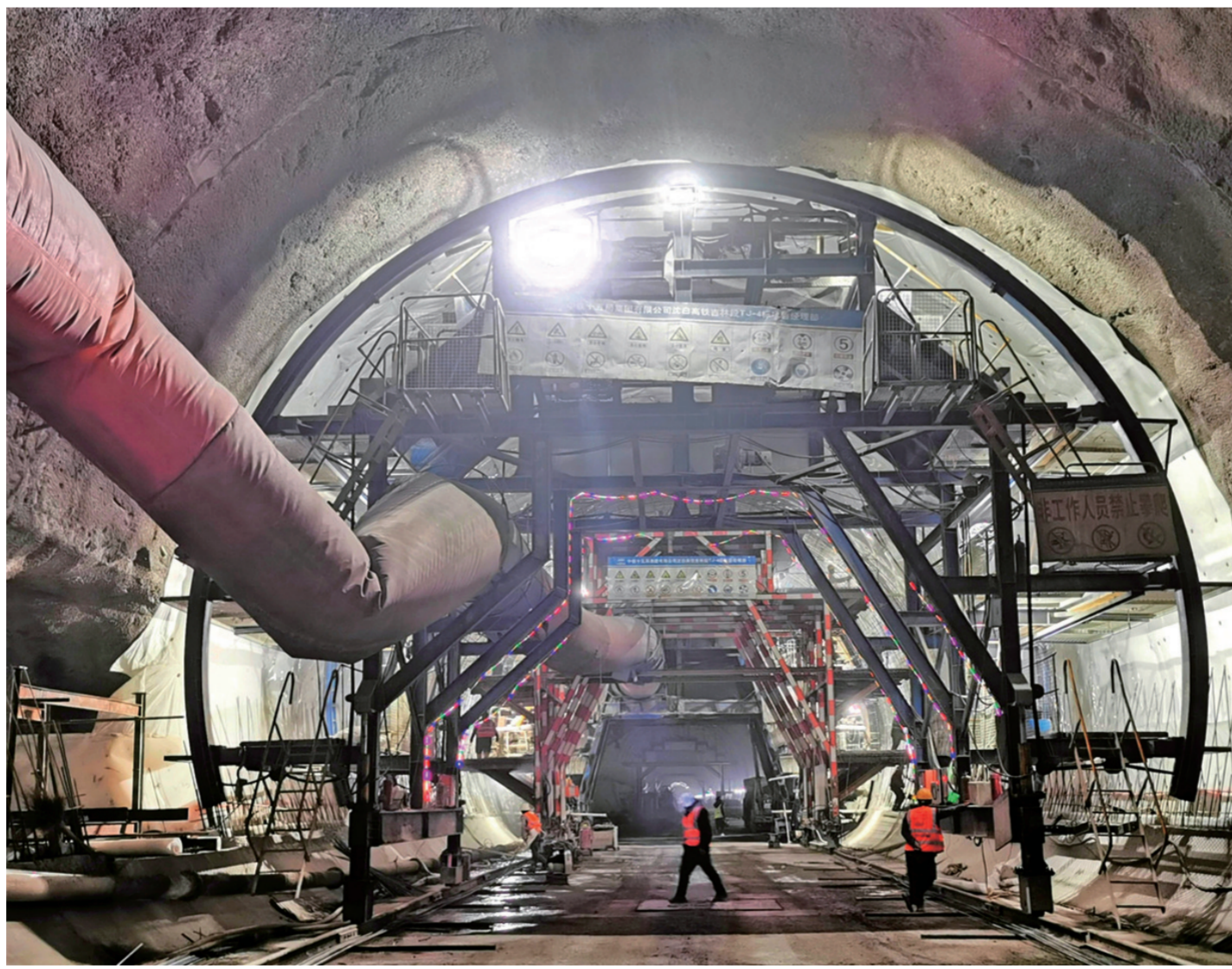
近日,经过建设者日夜奋战,位于通化县境内的沈白高铁吉林段全线控制性工程——双山隧道顺利贯通。该隧道全长5473.25米,标志着沈白高铁吉林段工程施工取得重大进展。 王新 本报记者 李铭 摄
