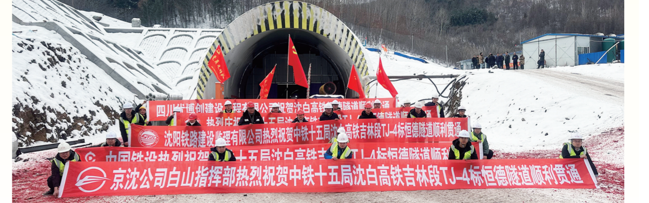
12月4日,中铁十五局沈白高铁吉林段TJ-4标项目工地再传喜讯,位于白山市境内的全长2226米的恒德隧道顺利贯通。沈白高铁建成通车后不仅将进一步完善东北地区的高速铁路网络,提升区域间的交通效率,也将有力地促进当地经济社会的发展,提高人民的生活水平。
