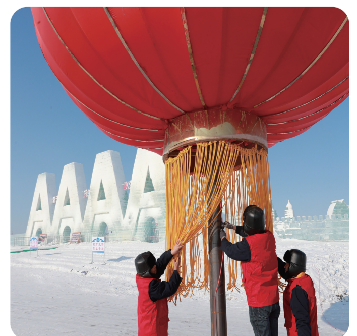
春节期间，国网松原供电公司“电把式”党员服务队在查干湖景区检查用电设备，确保安全供电。 张文琦 摄
