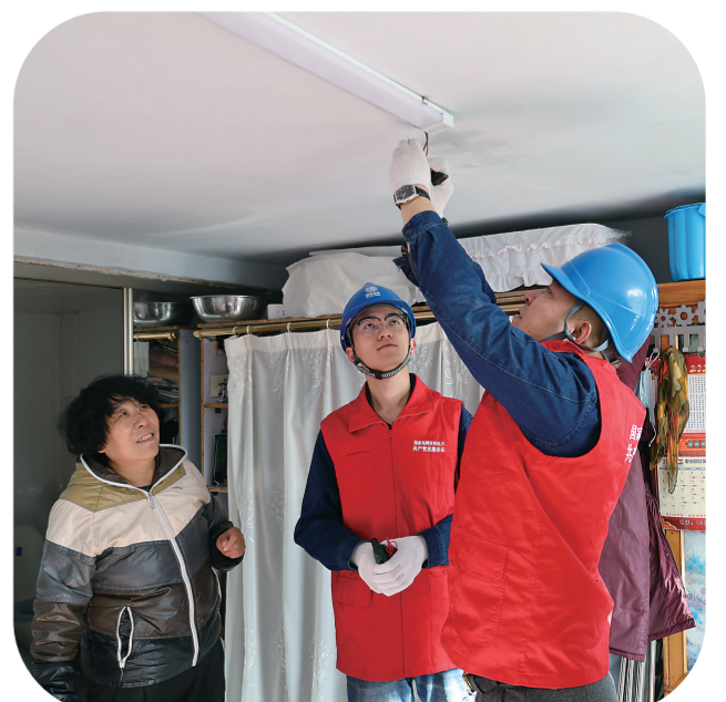
日前,国网安图供电公司共产党员服务队队员深入居民家中检查用电设备,确保用电安全。张迪 摄
