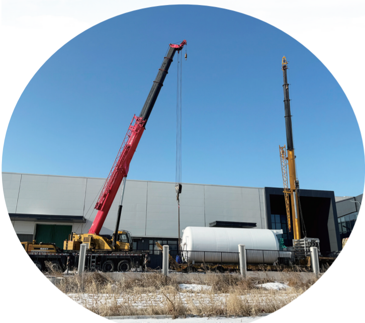
雪牛精酿年产2万吨设备购置项目现场正在吊装二氧化碳储罐。
