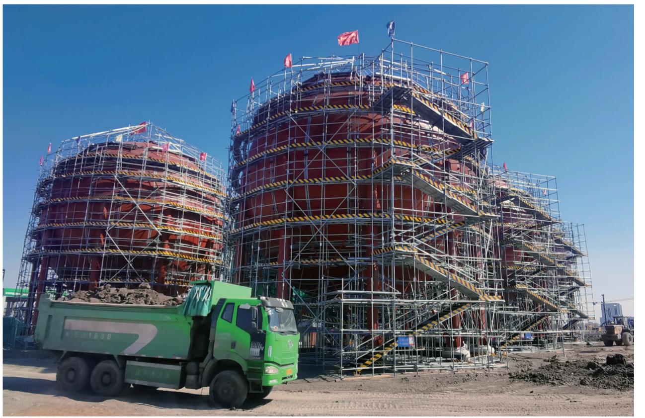
目前，大安风光制绿氢合成氨一体化示范项目正在紧张施工中。该项目是吉林西部千万千瓦级新能源制氢基地的重要组成部分，建成投产后，将年产绿氢3.2万吨、绿氨18万吨，可安置就业300余人。
