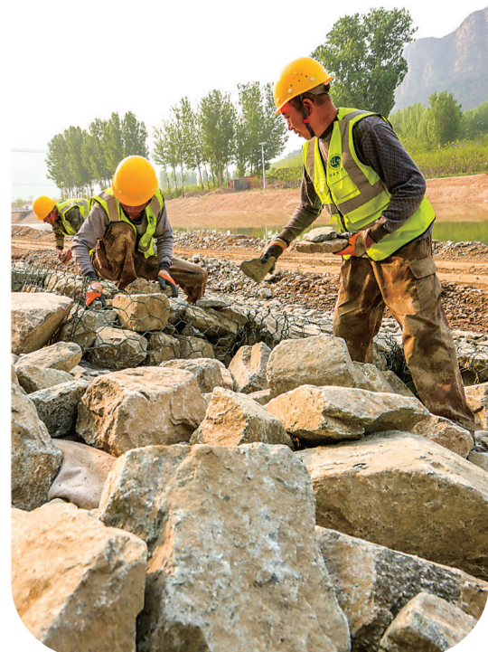
4月22日,工人在遵化市魏进河水系进行河道护坡加固施工。入春以来,河北省遵化市积极投入人力物力,加紧河道疏通、河堤加固工程施工,确保汛期安全。新华社(刘满仓摄)
