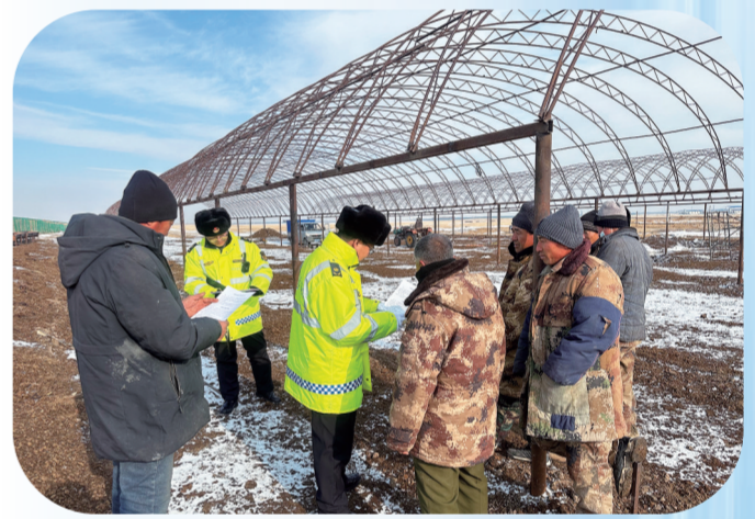
及时纠正建筑控制区违法施工行为。
