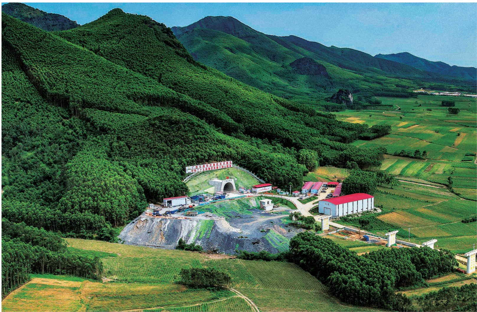
这是5月14日拍摄的广西柳州铁路六绵山隧道(无人机照片)。当日,广西柳州铁路首个中长途隧道——六绵山隧道顺利贯通,隧道全长2865米,为单洞双线隧道。柳州铁路正线全长238.167公里,设计时速160公里,项目计划2026年竣工。
