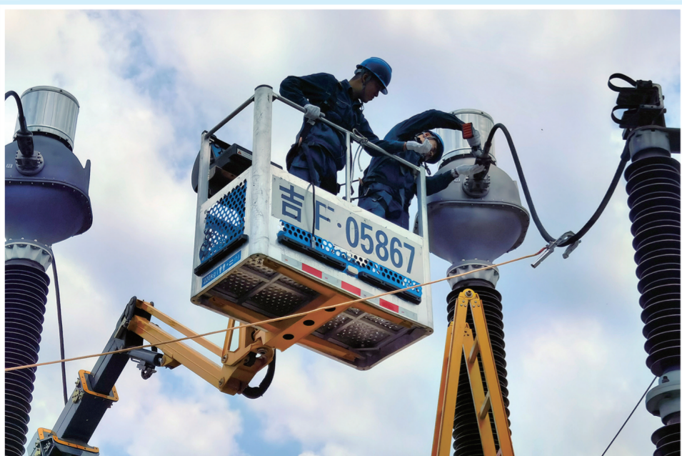
夏季来临,国网白山供电公司变电运检中心统筹谋划,开展检修检查,保障电力设施安全运行。图为作业人员正在更换220千伏电流互感器。
