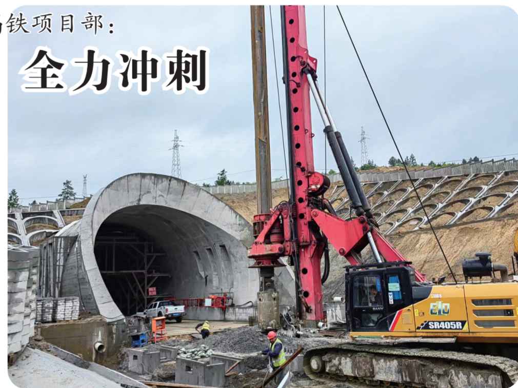
随着气候渐暖,中铁上海工程局沈白高铁吉林段TJ-5标项目部抓住有利晴好天气,加快建设。他们倒排工期,优化施工方案,明确节点目标任务,制订保障措施,加大过程考核力度,精心组织、合理安排,战晴天、抢雨天,日夜全力拼抢,目前,项目部累计完成产值30多亿元,占总工程量的85%。图为正在进行路基接触网钻孔。
