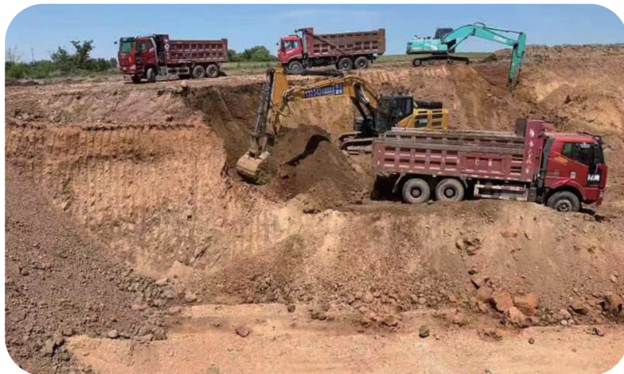
长春都市圈西环高速公路YNTJ01工区路基挖土方作业现场。
