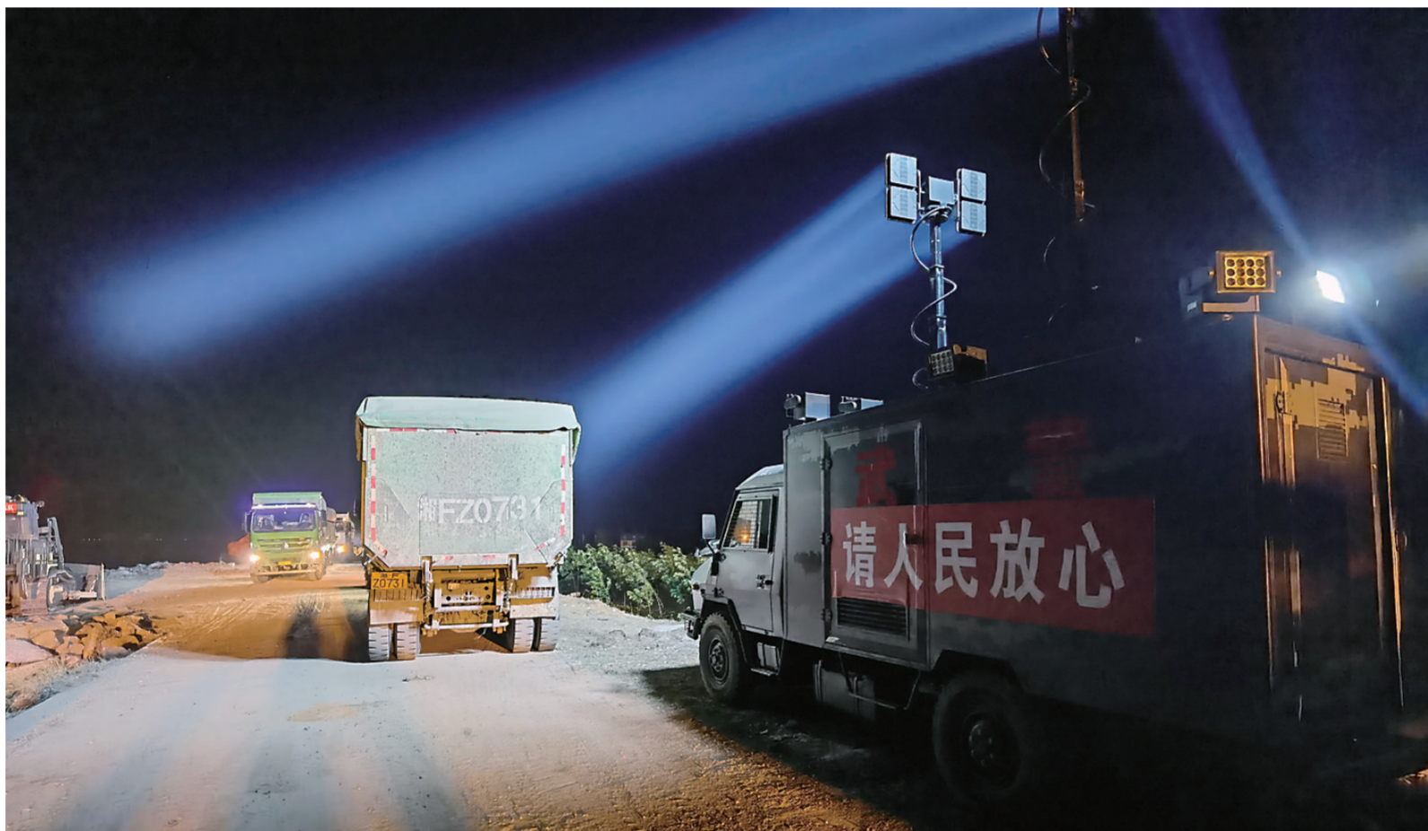
7月7日凌晨，在湖南省岳阳市华容县团洲垸洞庭湖一线堤防决口处，武警部队官兵出动照明车为施工现场提供照明。新华社记者 李秉宣 摄
