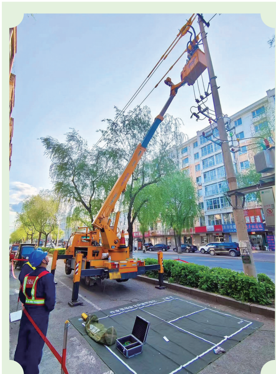
迎峰度夏期间,随着用电负荷的增加,国网白山供电公司浑江供电中心精心部署,周密安排,对辖区内重要配电网和大负荷节点进行特巡特护,发现并采取带电消缺方式及时处理隐患,确保电网安全稳定运行。苗敬文 摄
